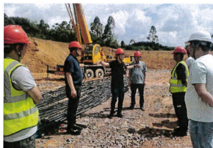
恩平市住房和城乡建设局检查“恩平市消防救援指挥中心一期工程（锦江新城北区消防救援站）”
