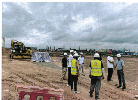
开平市住房和城乡建设局检查“谭江大道一期新建道路工程谭江生态湿地长廊”
