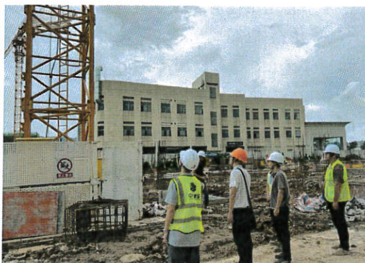
新会区住房和城乡建设局检查“新会区保障性安居工程住宅小区（三期）联和苑项目-1#住宅”
